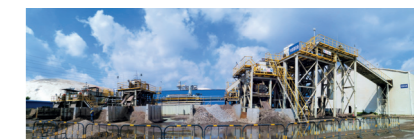
土壤淋洗装备在广州某项目示范应用
