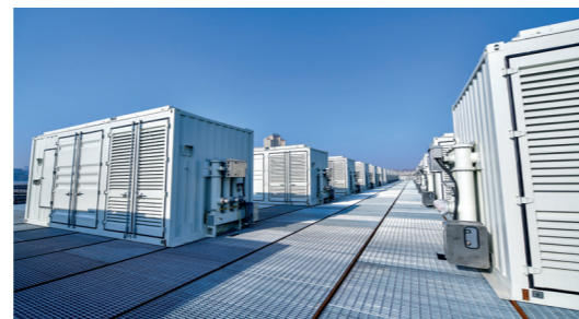
屋顶 PCS 系统放置现场
