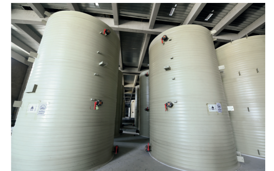
示范项目现场电解液储罐
